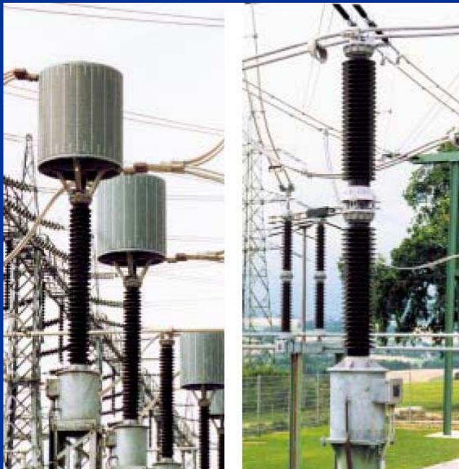
Trafos de tensión capacitivos
