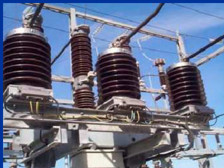
Trafo de intensidad
