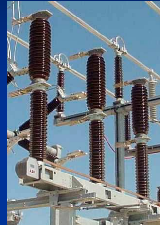
Interruptor y trafo de intensidad
