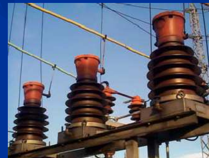
Trafo de tensión
