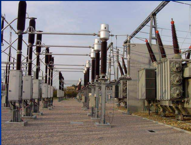
Posición de transformador
