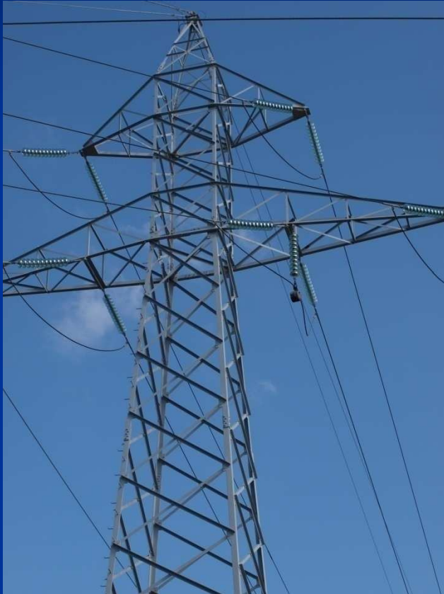
Líneas de entrada
