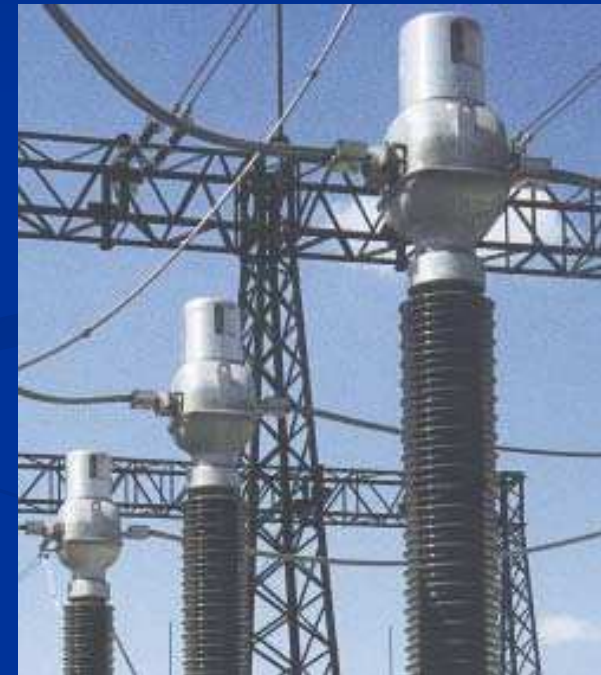
Trafos de intensidad
