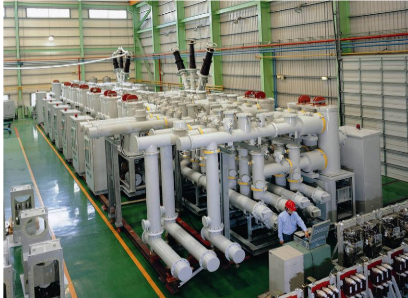
Subestación Interior aislada en SF6
