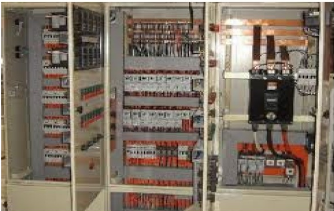
FIG. N° 11 TABLERO DE FUERZA
