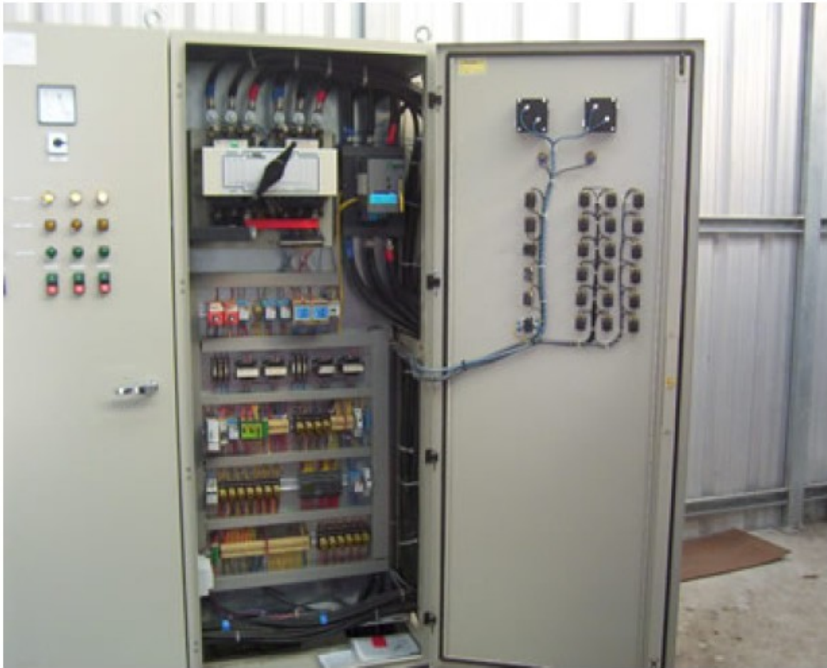
FIG. N° 12 TABLERO DE CONTROL
