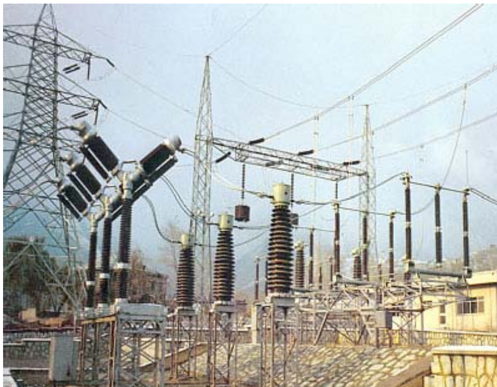
Figura 1.4 Subestación de sub-transmisión (alta tensión).
