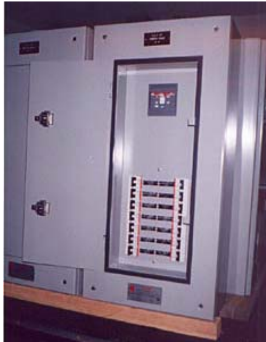
Figura 7.10 Tablero eléctrico fijo.
