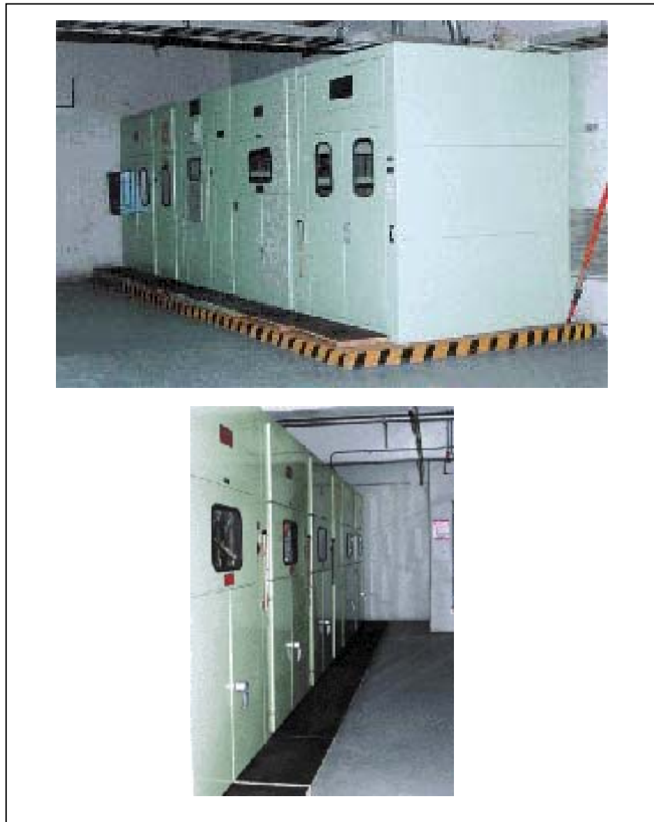
Figura 7.14 Tablero eléctrico tipo metal clad.
