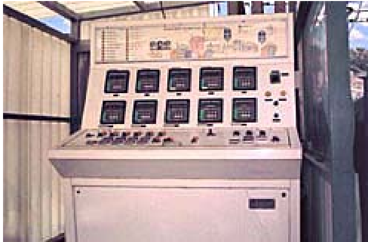
Figura 7.12 Tablero eléctrico tipo pupitre.
