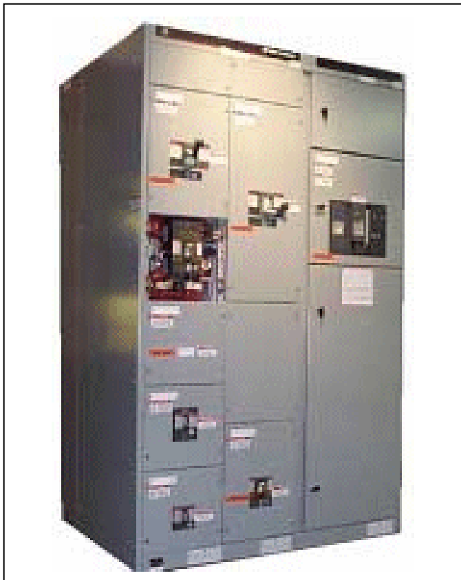
Figura. 7.16a Tablero eléctrico de Distribución.
