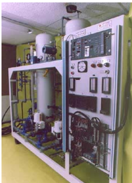
Figura 7.11 Tablero eléctrico desplazable.
