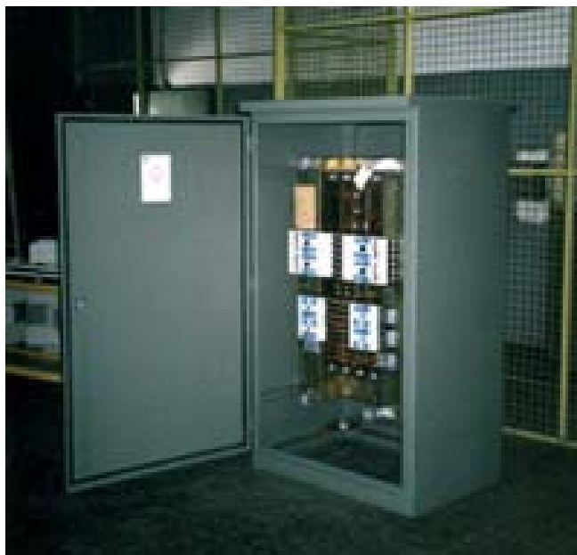
Figura 7.13 Tablero eléctrico tipo mural.
