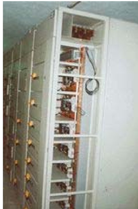
Figura 7.6b Tablero eléctrico con Protección frontal.
