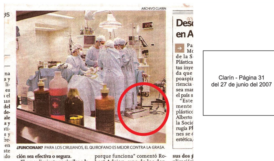
Figura 13 - Tomas múltiples (Zapatilla) conectados a un toma de quirófano. Riesgo de tierras a distinto potencial.
