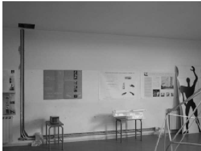
Roza en un muro de hormigón.
