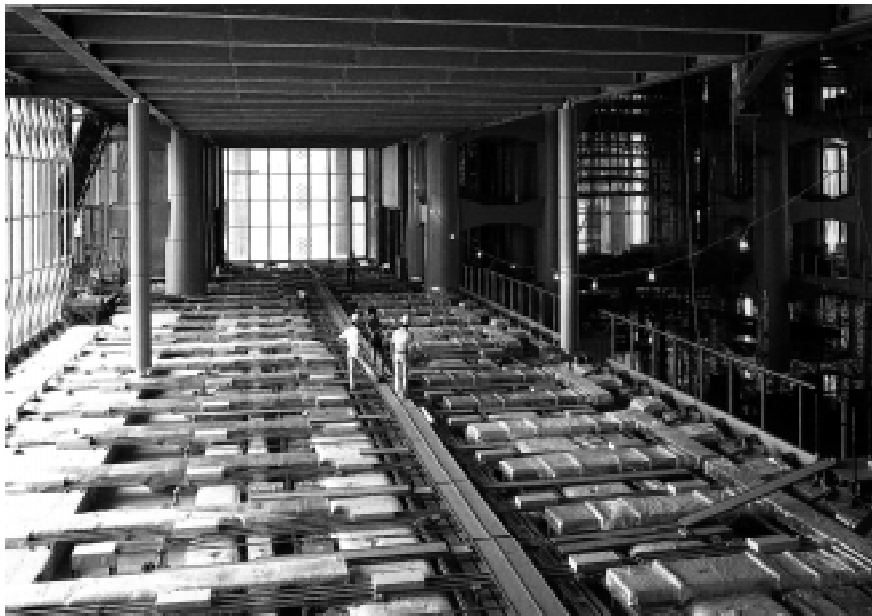
Las instalaciones tendidas en el falso suelo.
