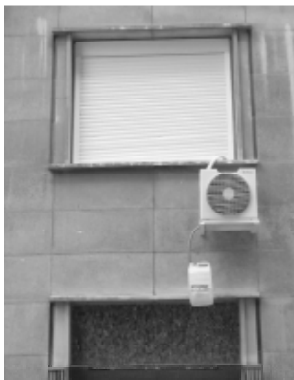
Recogida de condensados en un fachada murciana.
