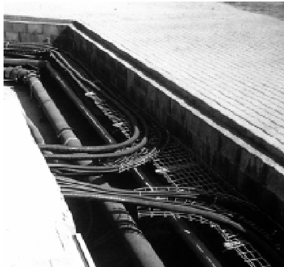
Galería de instalaciones en la Villa Olímpica de Barcelona.
