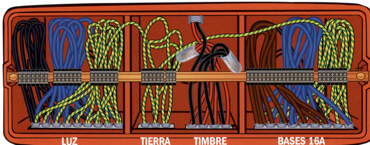
5. Ejemplo de cableado acabado dentro de la caja de derivación principal realizado con bornas sobre carril DIN
