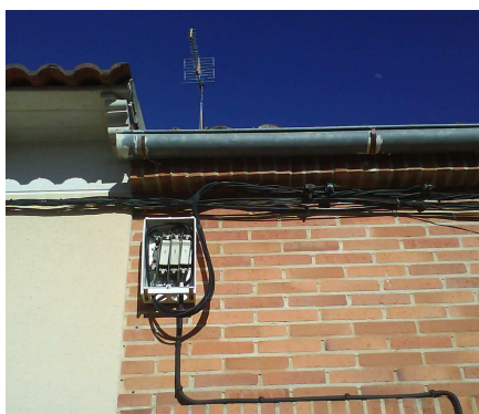
Acometida aérea en fachada y CGP
