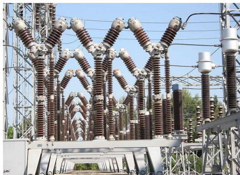
Subestación de transformación
