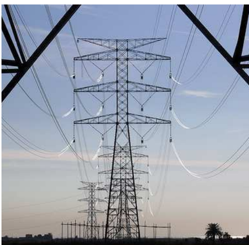
Líneas de alta tensión
