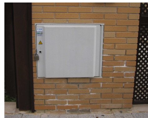
CGP en fachada de un edificio
