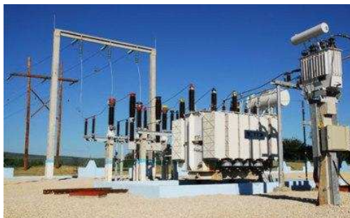
Estación de transformación
