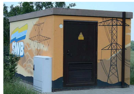
Centro de transformación
