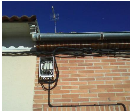
Acometida aérea en fachada y CGP
