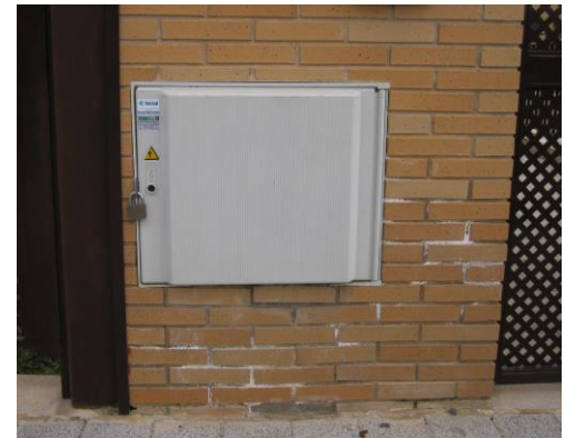
CGP en fachada de un edificio
