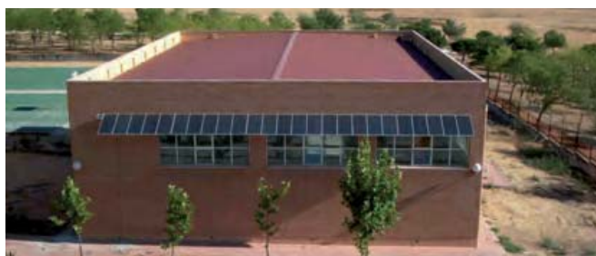
Foto 1.2. IES Victoria Kent, Madrid. Instalación fotovoltaica.
