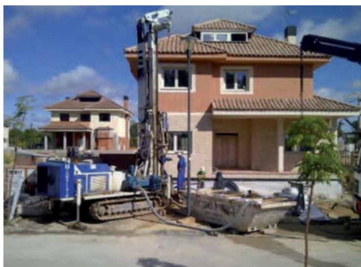
Foto 5.12. Geotermia en vivienda unifamiliar. Fuente: Girod Geotermia.
