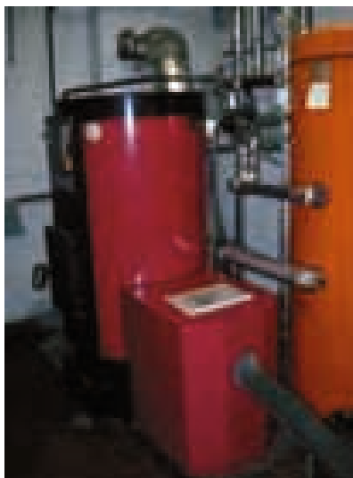
Foto 8. Caldera para vivienda unifamiliar (25 kW).
