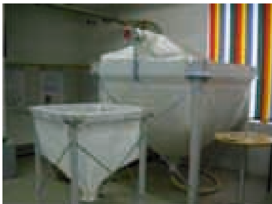
Foto 10. Silos de polipropileno para pellets (capacidad de 2 a 5 toneladas).
