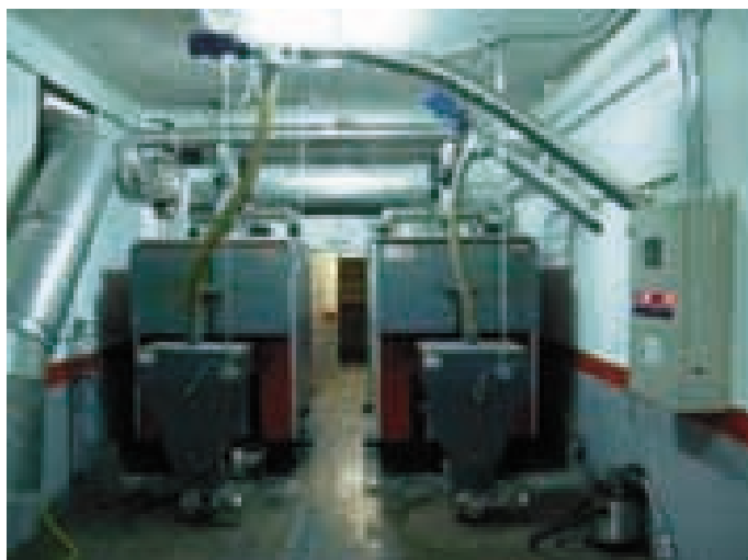
Foto 7. Calderas de biomasa de tamaño medio (450 kW cada una).
