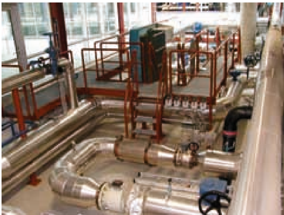
Foto 2. Central binaria en Islandia.
