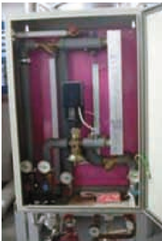
Foto 5. Intercambiador de placas.
