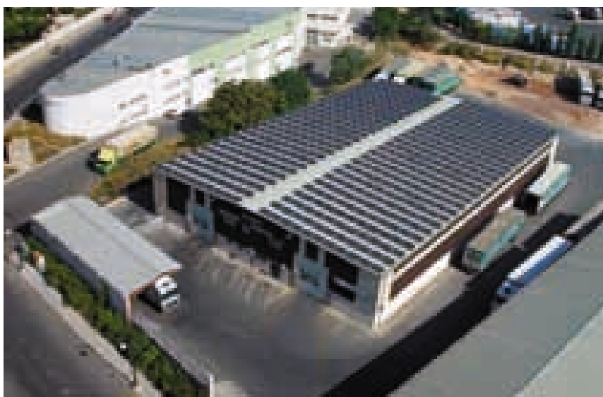
Foto 3. Instalación fotovoltaica en tejado.
