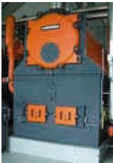
Foto 2. Caldera de biomasa para district heating (850 kW).
