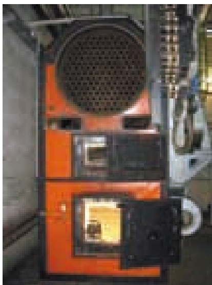
Foto 4. Caldera de parrilla abierta (1.500 kW).
