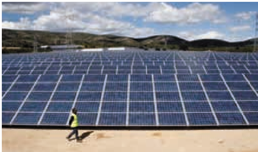
Foto 2. Instalación solar fotovoltaica.
