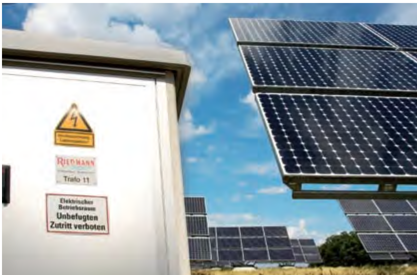
Fig.10: Los sistemas fotovoltaicos de gran escala alimentan comúnmente su salida a un transformador que convierte la energía a un nivel de media tensión
