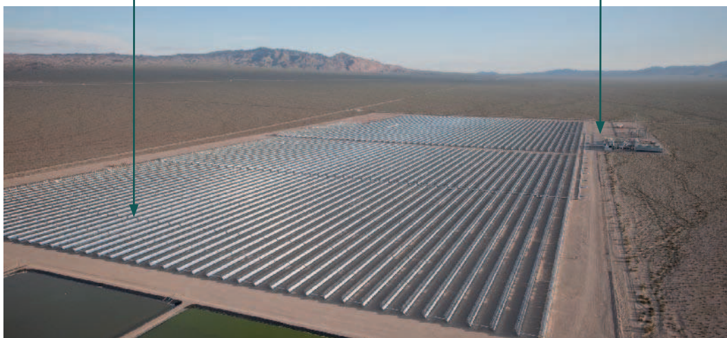
Fig. 1.5. Central FV aislada en el desierto de Nevada.
