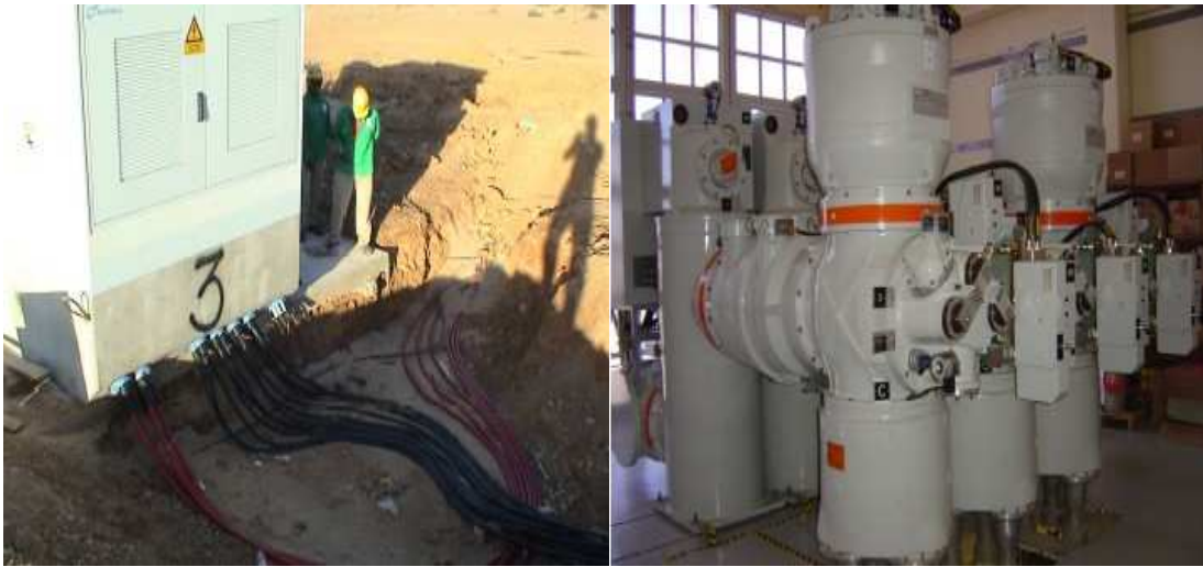
Figura 54. Cables de Salida del aerogenerador para ser conducidos subterráneamente a la Subestación Encapsulada en SF6 que le da salida al Transformador 13,8 KV / 110 KV.
