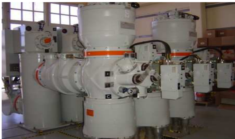
Figura 26. Subestación Encapsulada de Jepirachi [17]
