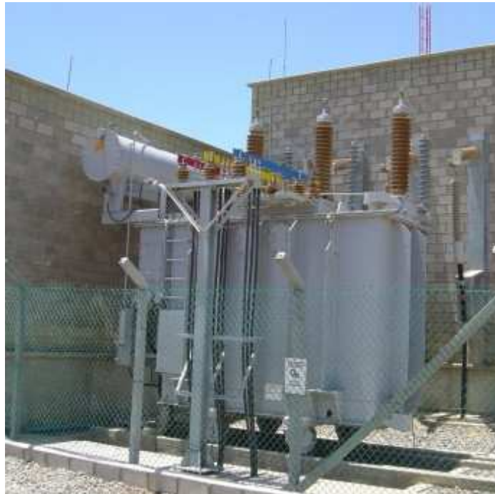
Figura 27. Transformador Principal de Jepirachi [17]
