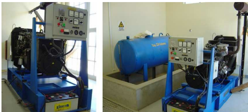
Figura 58. Planta de Emergencia.
