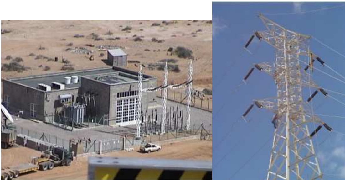
Figura 55. Subestación 13,8 / 110 KV Saliendo 800 m hasta T20 de la Línea de Transmisión Cuestecitas a Puerto Bolívar del proyecto carbonífero Cerrejón.
