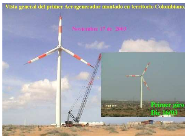
Figura 51. Primer Aerogenerador instalado en Colombia, marca Nordex N60/25 {17}.
