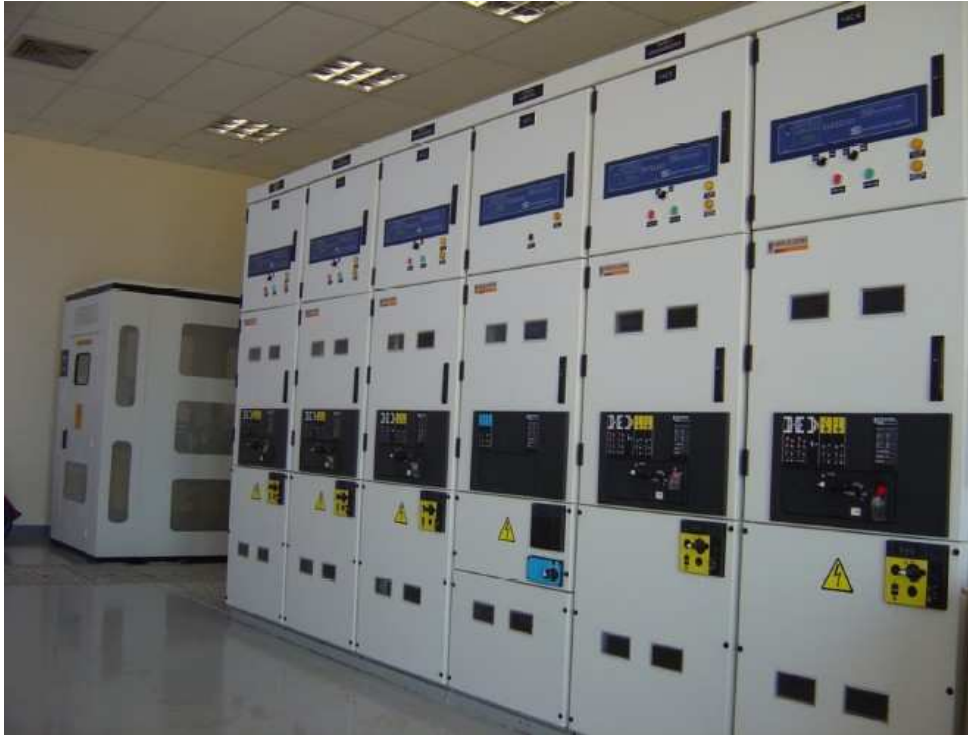
Figura 57. Equipos de Control y Monitoreo de Las Turbinas N60/250 1300 KW.
