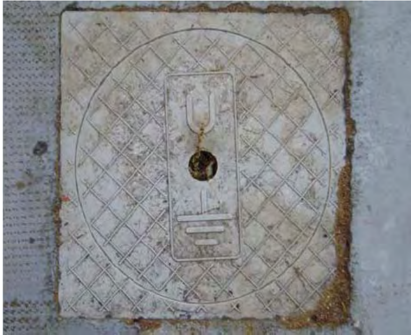
Figura 15. Toma de tierra.
