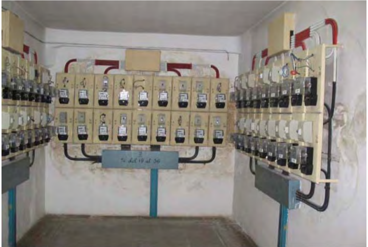
Figura 5. Centralización de contadores.
