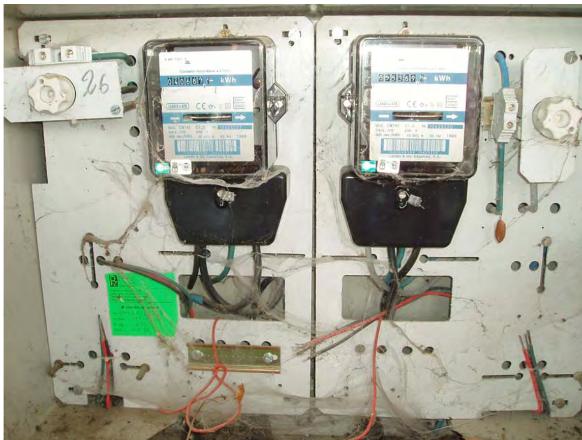
Figura 7. Detalle de contadores de inducción.
