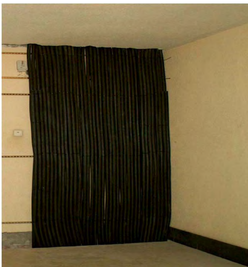
Figura 8. Canalizaciones de derivaciones individuales.
