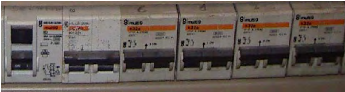
Figura 10. Pequeños interruptores automáticos (PIAs).
